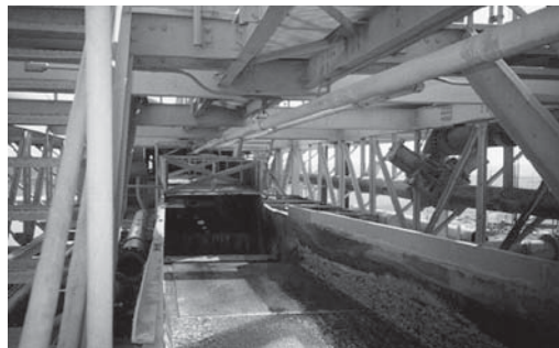
Фото В Сочетание истирания и коррозии вызвало значительное изнашивание стали 400 BHN, используемой в лотковых транспортерах.
