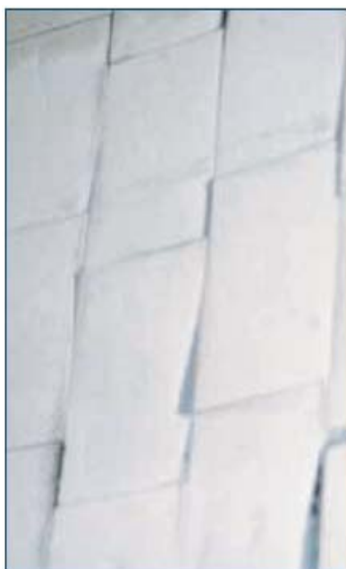
Значительная эрозия вокруг швов
