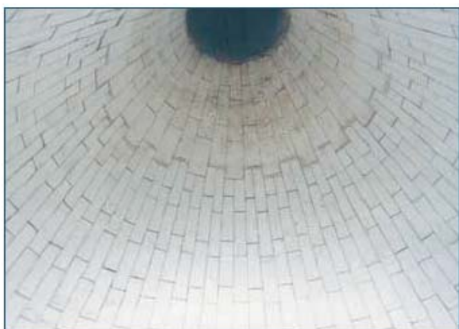
Футеровка высокотемпературного циклона отходов Мусоросжигательный завод (высокое количество коррозии) Эксплуатационный период: сталь < 1 года, керамика > 7 лет
